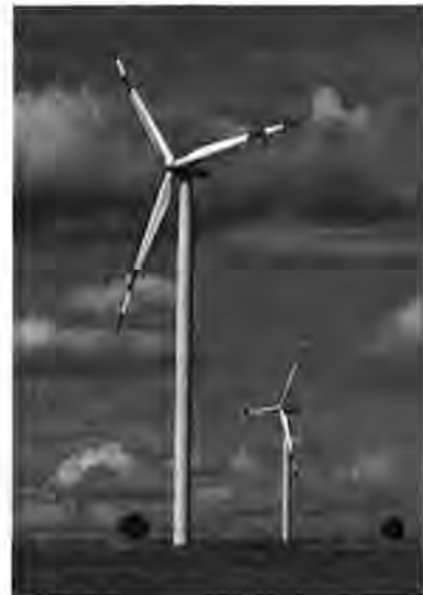
Figure 1. Aérogénérateurs GE 2.5MW en opération sur un site éolien Client.
