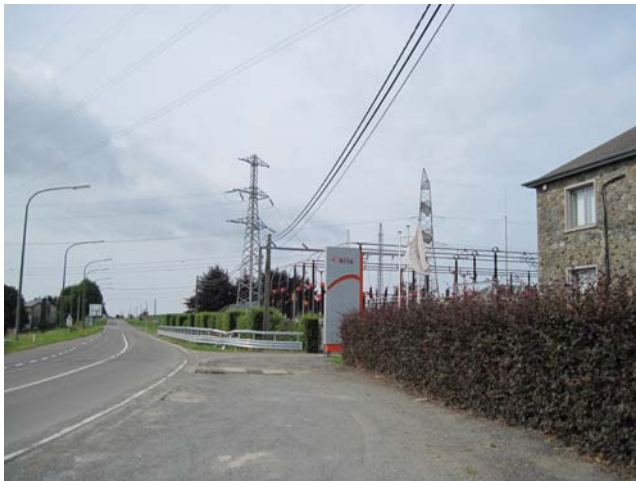
Figure 8-16 : Poste d'injection de Villeroux
